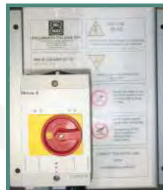
“E” - interruptor magnetotérmico con funciones de arranque y parada, con protección térmica del motovibrador.
